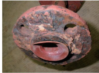
図14 フランジ部の腐食
