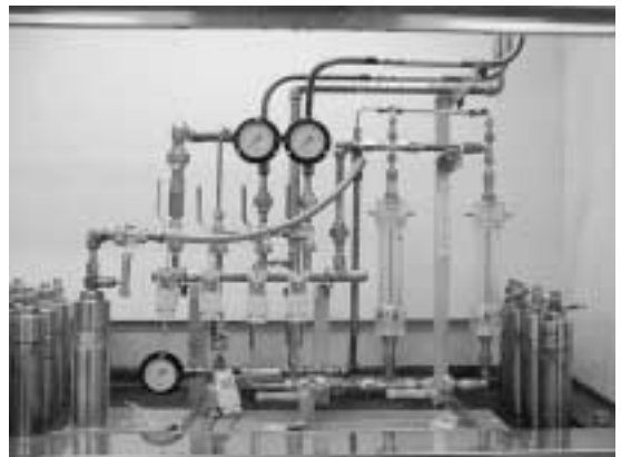
写真2 液注入・ガス排出装置
