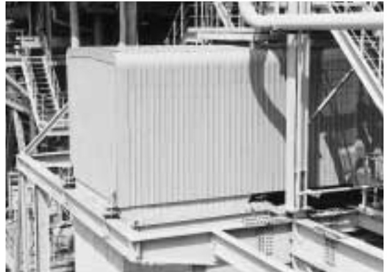
写真3 ダクト施工例
