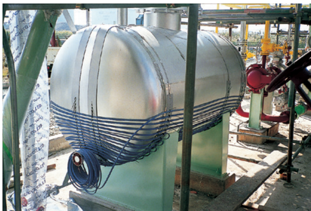
図1 タンクへの自己制御型ヒータ施工例
