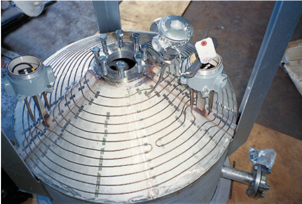
図6 タンクへのMI型ヒータ施工例
