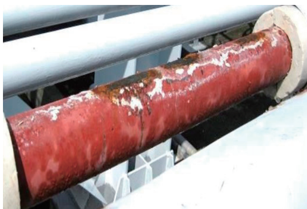
図7 保温材下配管外面腐食(CUI)の例
