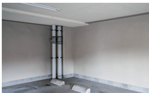
図1-a マンション駐車場 天井使用部
