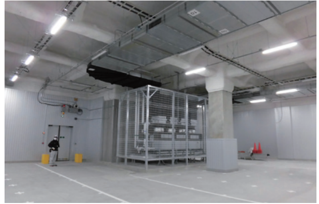
図2 荷物の入庫を待つ冷蔵室
