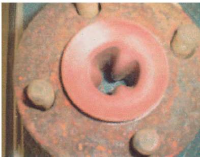
図13 ライニング層の座屈
