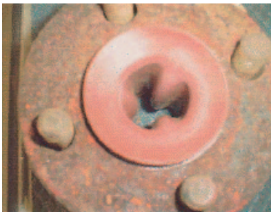
図13 ライニング層の座屈
