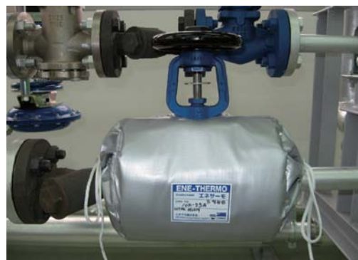
写真2 エネサーモ取付後のバルブ
