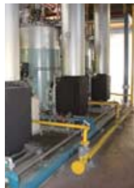
羽島工場ガスボイラー
